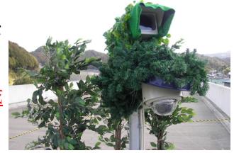
↑ 観測システムの設置状況 (上：高倍率カメラ、下：広角カメラ)
