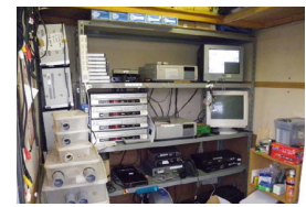
↑ 監視小屋内の機器類
