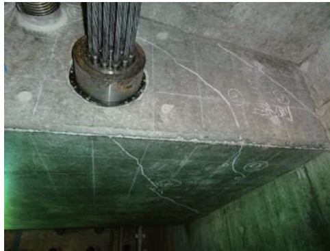
写真-3.3.1 定着突起のひび割れ
