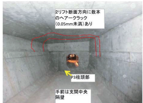
写真-5.2.2 箱桁内部のひび割れ
