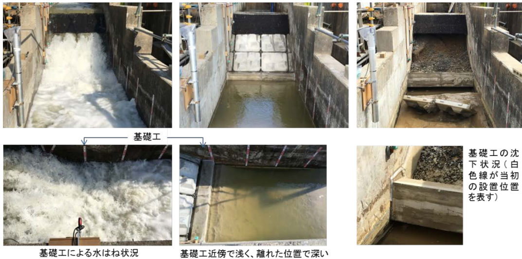
写真-11 のり尻補強工：実物矩形での越流*・洗掘*・破壊状況（*：越流水深 30cm）
