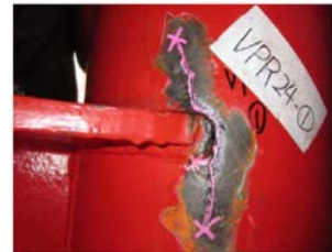
写真 1 管部材に生じた疲労亀裂
