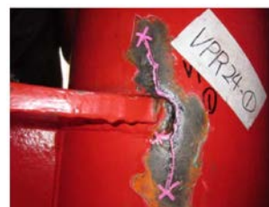
写真1 管部材に生じた疲労亀裂
