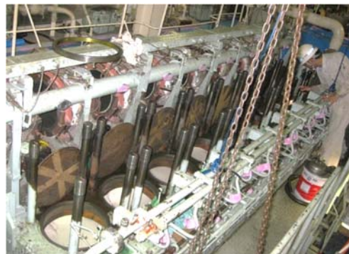
写真-4.4 主発電機関解放状況
