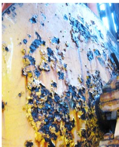
写真-4.12 処理機昇降用ウインチの状況
