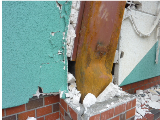
写真 5.4-12 柱の局部座屈
