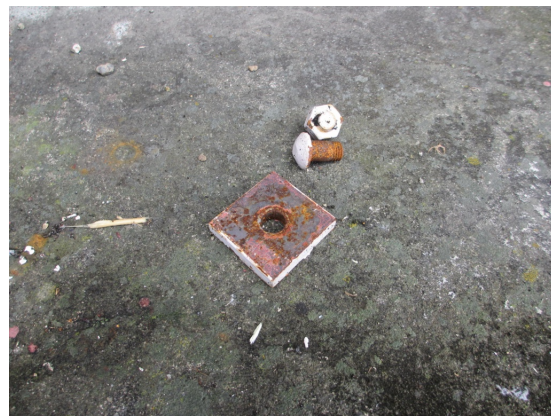
写真 5.4-94 破断した交差部のボルトとブレースの間に挿入されていたプレート
