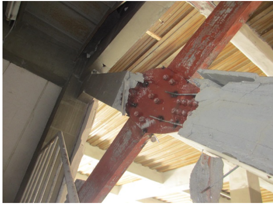
写真 5.4-194 ブレース交差部のガセットプレート接続部の座屈
