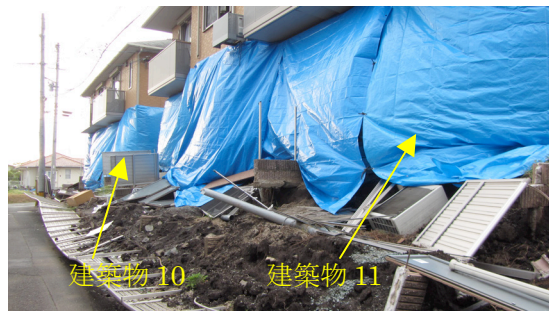
写真 5.4-24 宅地擁壁部分の崩壊
