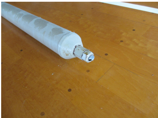
写真 5.4-155 落下したトラス下弦材
