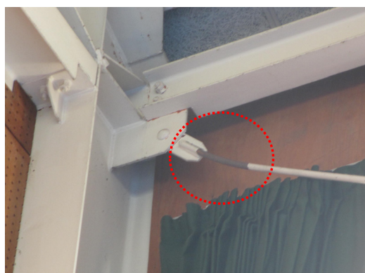
写真 5.4-120 ブレース端部の塑性化の様子
