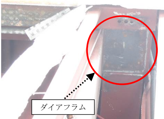
写真 5.4-13 柱とダイアフラム間の溶接部の破断
