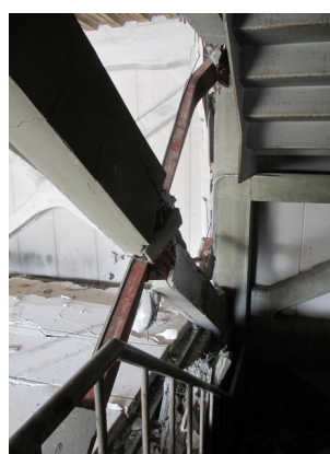
写真 5.4-191 ブレースの耐火被覆の剥落
