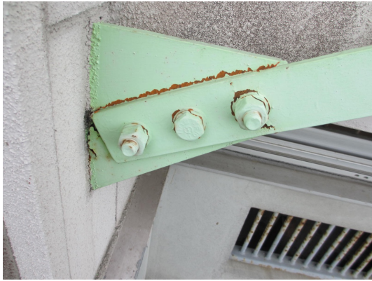
写真 5.4-128 ブレース接合部におけるブレースのわずかな滑り
