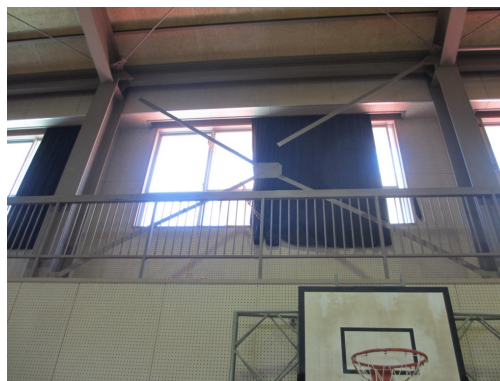
写真 5. 4-164 2階のブレースの破断
