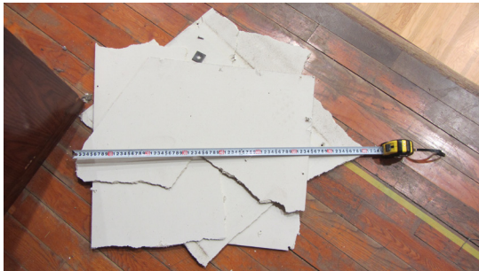
写真 5.4-103 落下した舞台上部内壁の仕上げ材
