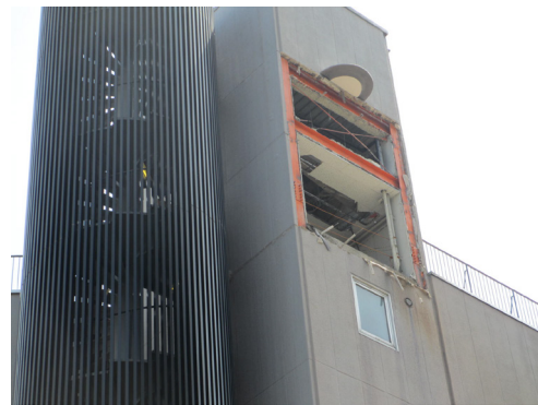
写真 5.4-196 塔屋の外装材の脱落
