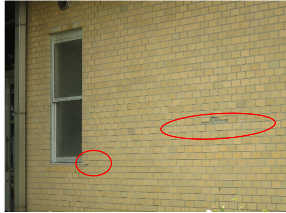
写真5.4-98 外壁のひび割れ・タイル剥落 (赤円内にひび割れ・タイル剥離)
