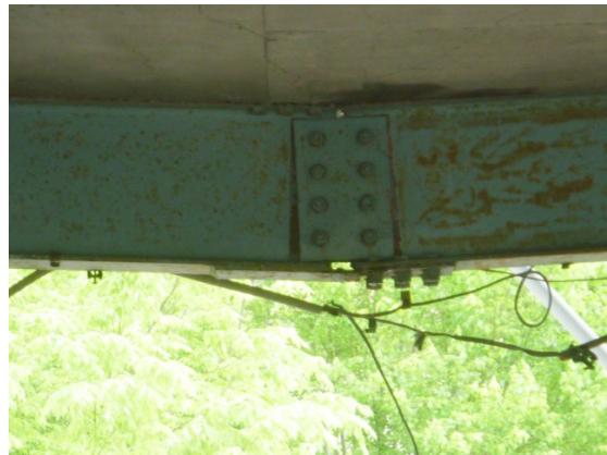
写真 5.4-6 梁下フランジ添え板の孔欠損部破断
