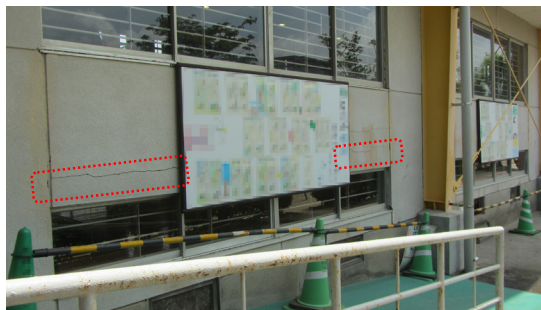
写真 5.4-115 1階外壁の水平なひび割れ
