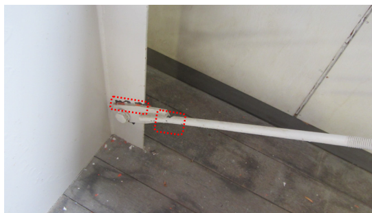
写真 5.4-113 2階鉛直ブレース下端接合部 塗料の剥げ、ブレースの若干の変形
