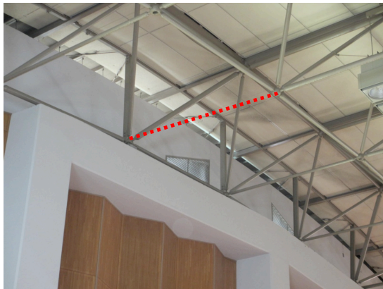
写真 5.4-153 落下したトラス部位
