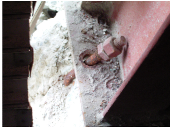
写真 5.4-17 柱脚部の損傷状況
