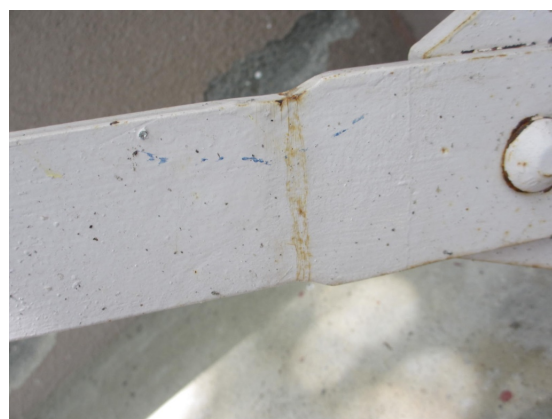
写真 5.4-90 ブレース母材と端部の幅広プレートの境界がわずかに降伏 (写真 5.4-89 の拡大)
