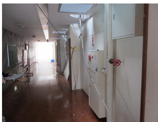
写真5.4-175 体育館Iのブレースの大きなたわみ及び伸び
