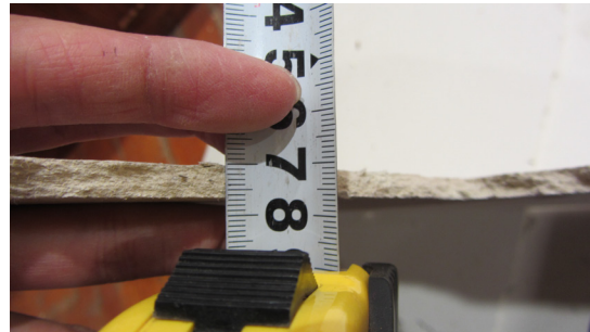
写真 5.4-104 落下した舞台上部内壁の仕上げ材
