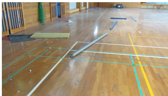
写真 5.4-142 落下した立体トラスの部材
