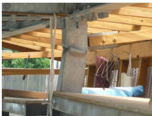
写真 5. 4-41 柱の局部座屈
