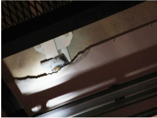
写真 5.4-186 体育館Nのステージ上の屋根支承部のコンクリートの破壊
