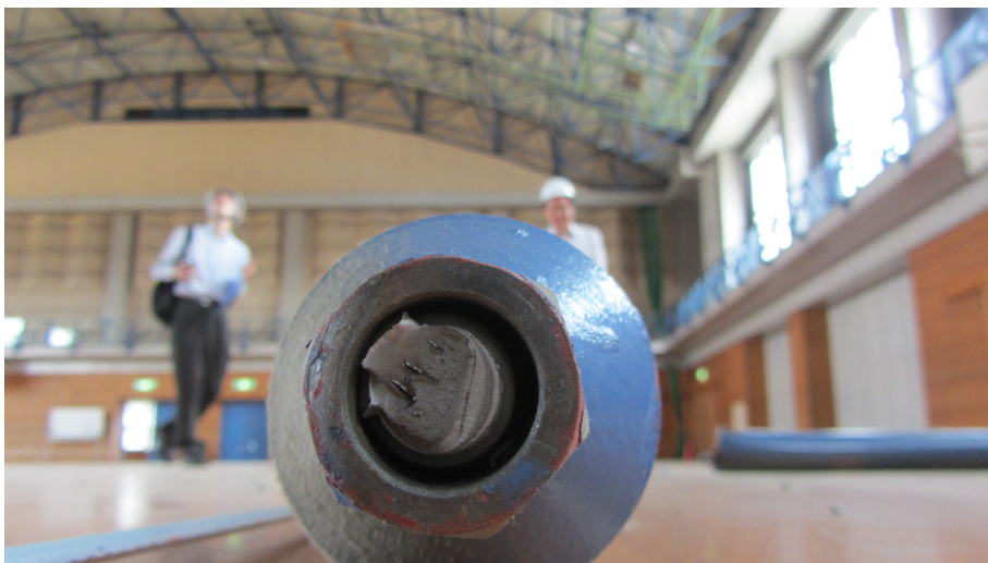
写真 5.4-144 落下した立体トラス部材の端部 (ボルトの破断)
