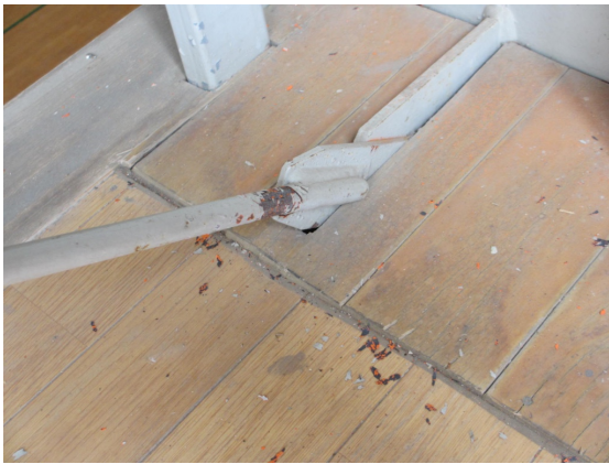
写真 5. 4-45 ブレース端部の塑性化
