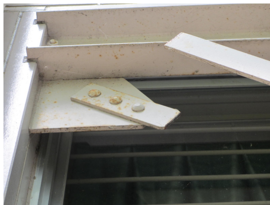
写真5.4-173 体育館Fの母材破断
