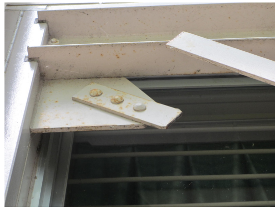
写真 5.4-88 平鋼ブレースの端部での破断 (写真 5.4-87 の拡大)
