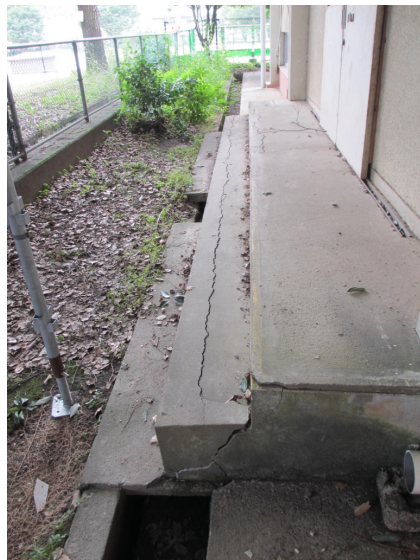
写真 5.4-52 周辺地盤の沈下
