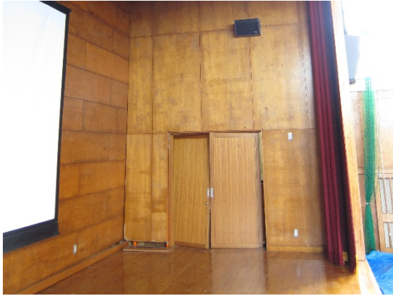
写真 5. 4-124 舞台壁の損傷、引き戸の外れ
