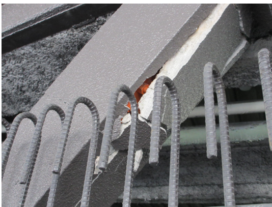
写真 5.4-197 ブレース端部の耐火被覆の亀裂
