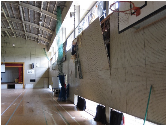
写真 5.4-53 損傷して傾いた内壁
