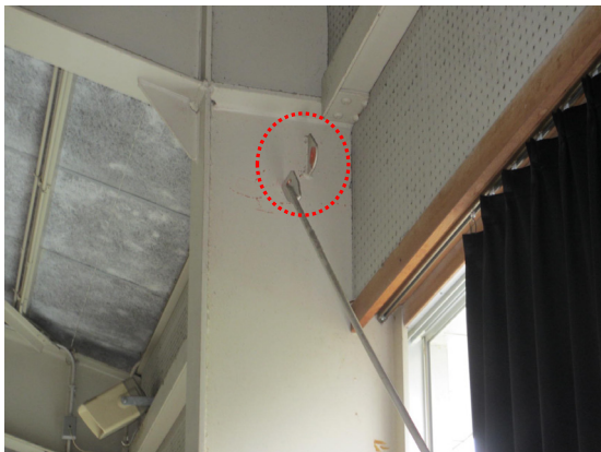
写真 5.4-80 鉛直ブレースのボルト破断
