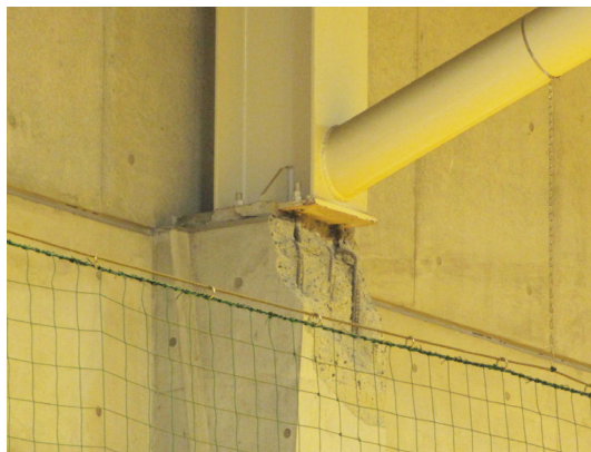
写真 5.4-56 支承部のコンクリートの側方破壊
