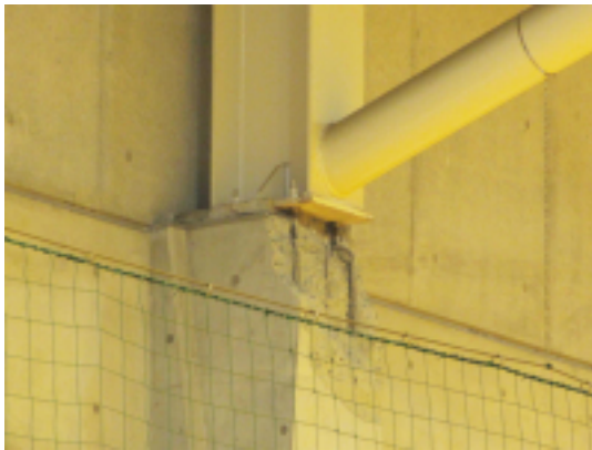
写真 5.4-184 体育館Bの屋根支承部のコンクリートの側方破壊
