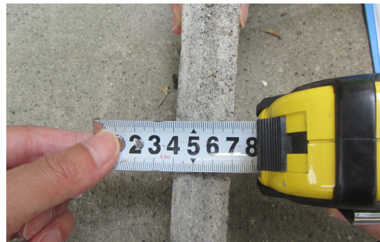
写真 5.4-117 左の落下したモルタル (厚さ約3cm)
