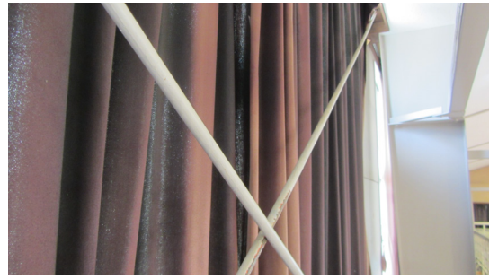
写真 5.4-112 2階鉛直ブレース (交点での擦れ)
