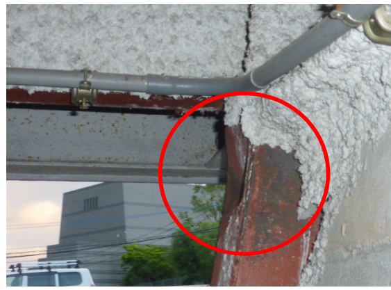
写真 5.4-28 柱の局部座屈
