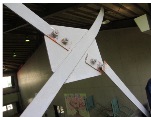
写真 5. 4-166 孔欠損部での破断
