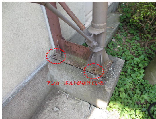
写真 5. 4-150 柱脚のアンカーボルトの破断
