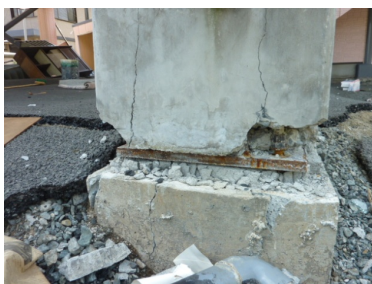
写真 5.4-37 柱脚部の損傷状況
