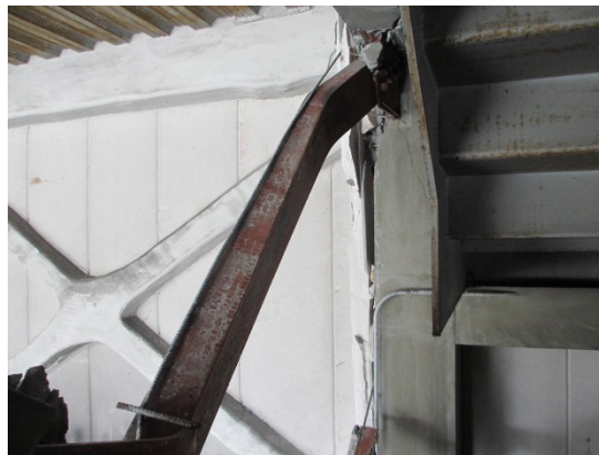
写真 5.4-193 溝形鋼ブレース端部の座屈
