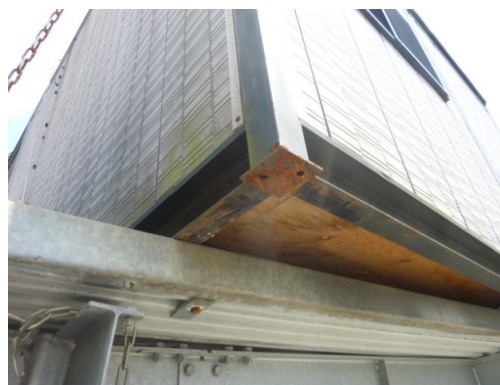
写真 5. 4-42 柱脚部ボルト破断
