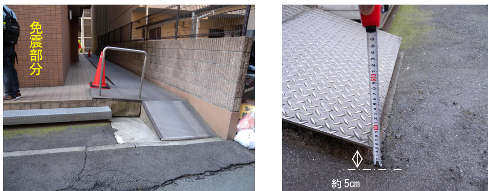
写真 5.7.2-58 周囲における地盤沈下の痕跡（隣接する塀の傾斜、エキスパンション部の隙間）
