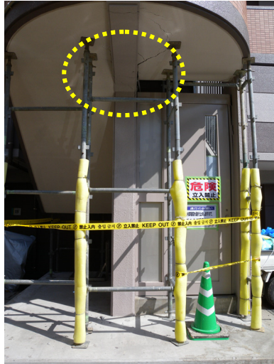
写真 5.7.2-45 外階段の被害
