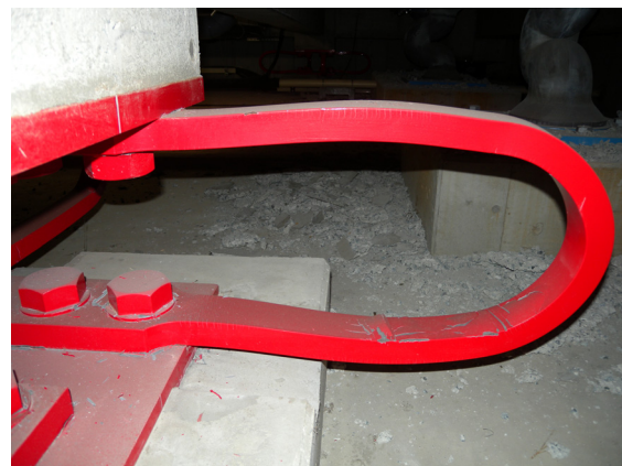
写真 5.7.2-19 鋼材ダンパーの変状
