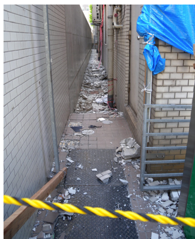
写真 5.7.2-16 隣接建物（右側）の外装材落下被害
