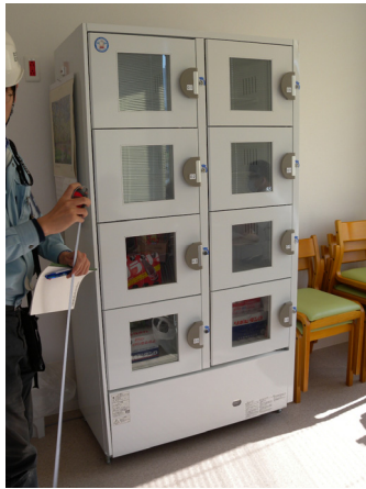
写真 5.7.2-6 転倒したロッカー① (2階病棟内)
