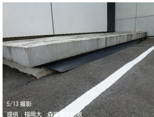
写真 5.7.2-60 免震スカートのはみ出し
