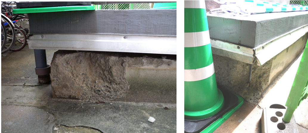
写真 5.7.2-42 鉛直クリアランス部分の変状
