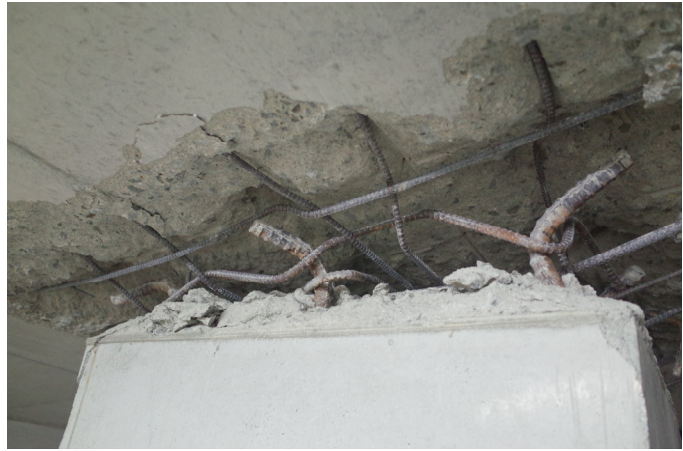
写真 5. 7. 2-50 鉛ダンパー取付け基部の損傷
