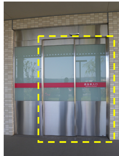
写真 5.7.2-5 外れた自動ドアの扉（復旧済み）
