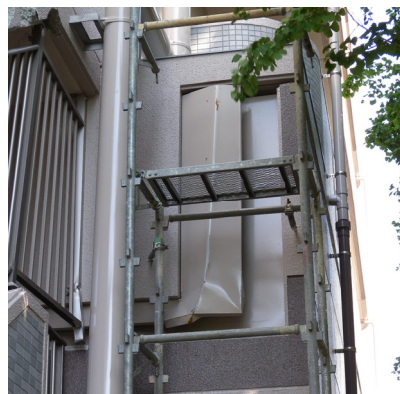
写真 5.7.2-48 同 状況③（カバーの変形）
