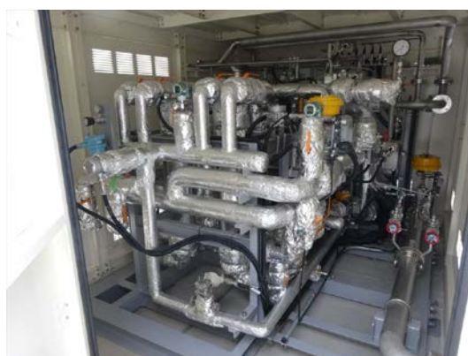
ガス分離膜装置
