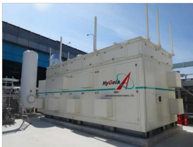
図 2 - 10 水素製造設備写真
