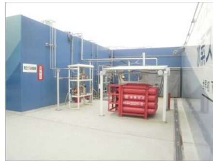
水素出荷設備
