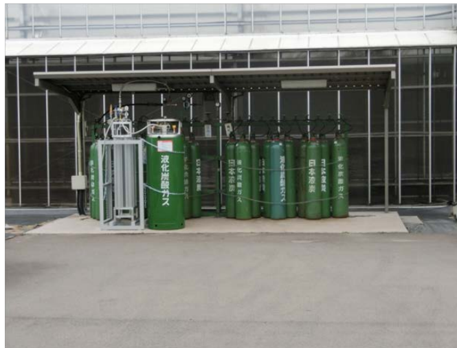
液化 CO 2 タンク
