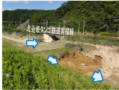
写真-3.2.25 由良川堤防と北近畿タンゴ鉄道盛土 (9月19日調査)
