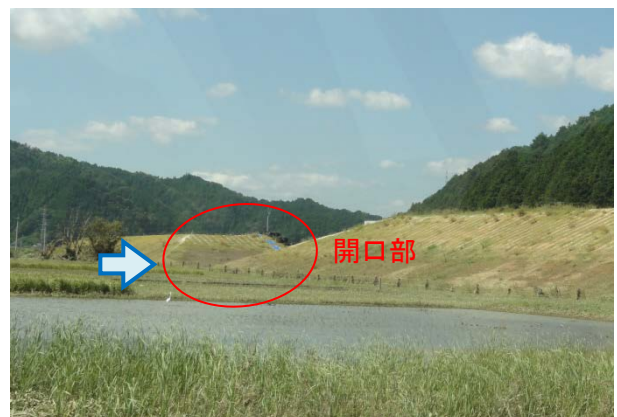
写真-3.2.30 緊急水防災対策施工中の開口部より溢水 (9月19日調査)
