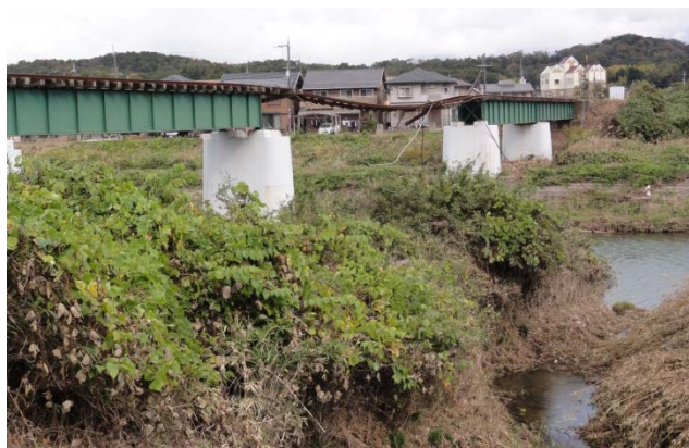
写真-3.3.1 信楽高原鐵道仙川橋梁橋脚流出 (11月13日調査)
