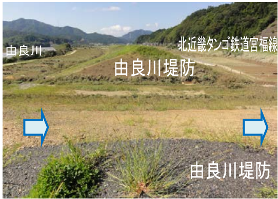
写真-3.2.24 緊急水防災対策施工中の開口部より溢水 (9月19日調査)
