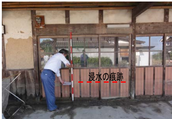
写真-3.2.14 南鴨地区の家屋における浸水痕跡 (9月18日調査)
