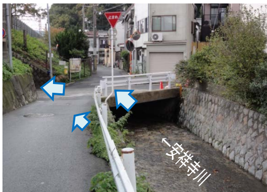
写真-3.2.34 安祥寺川の溢水箇所（11月15日調査）
