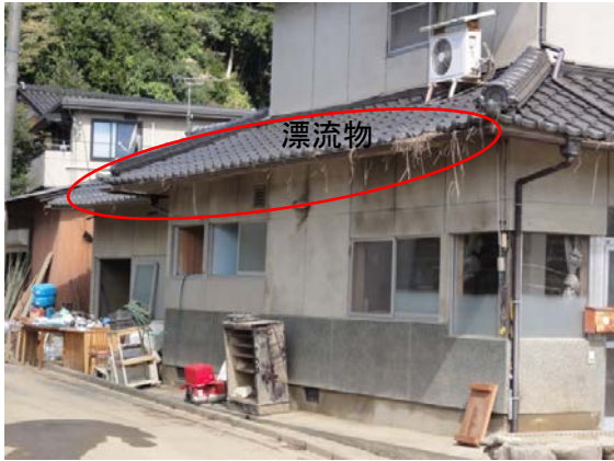
写真-3.2.31 家屋1階屋根の浸水痕跡 (9月19日調査)
