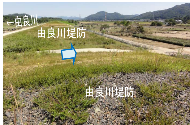
写真-3.2.17 緊急水防災対策施工中の開口部より溢水 (9月19日調査)
