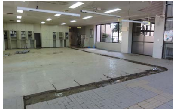
写真-3.2.27 福知山市役所大江支所1階が浸水（清掃のため備品等は一時的に搬出） (9月19日調査)
