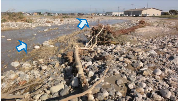
写真-3.2.10 堤防決壊地点近傍の農地 (9月18日調査)
