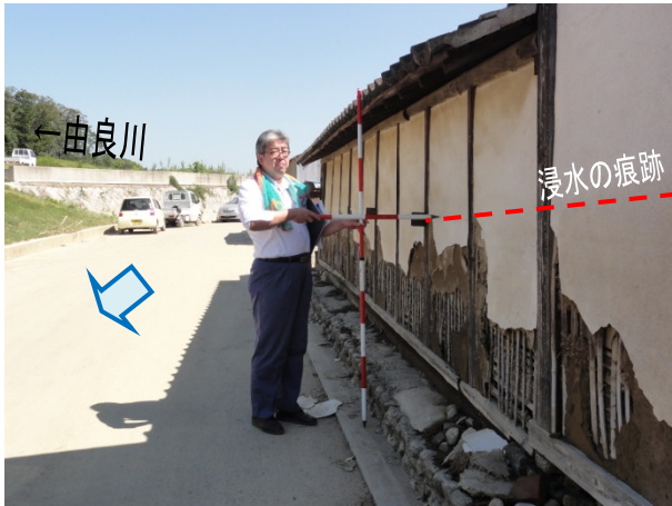
写真-3.2.18 戸田地区における 家屋外構の浸水痕跡 (9月19日調査)
