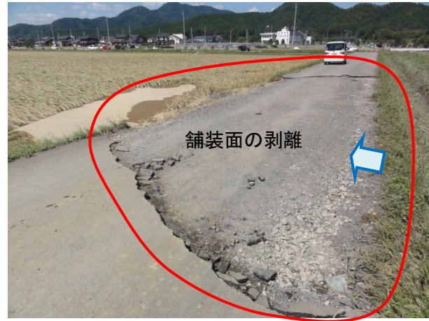
写真-3.2.19 戸田地区の農道における舗装面の剥離 (9月19日調査)
