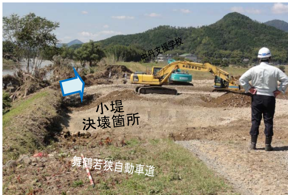
写真-3.2.20 私市地区小堤決壊箇所 (9月19日調査)
