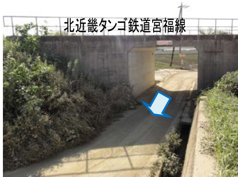
写真-3.2.26 北近畿タンゴ鉄道の盛土開口部 (9月19日調査)
