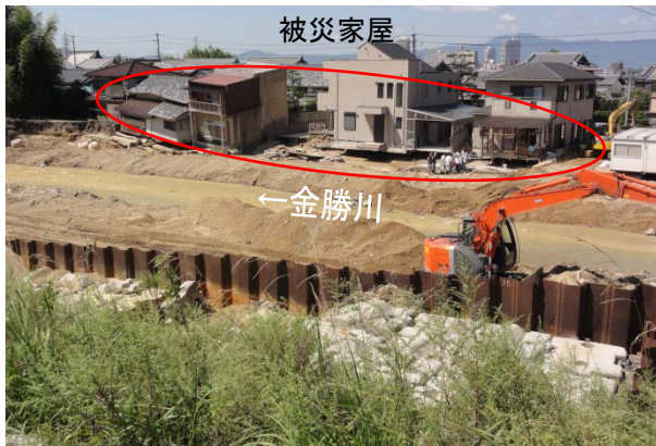
写真-3.2.4 堤防近傍の家屋の被害状況 (9月18日調査)
