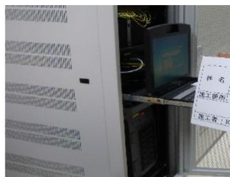
小型光水位計動作確認 (センター装置側)
