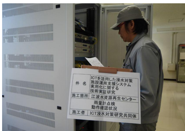
光雨量計点検／信号受信状況確認
