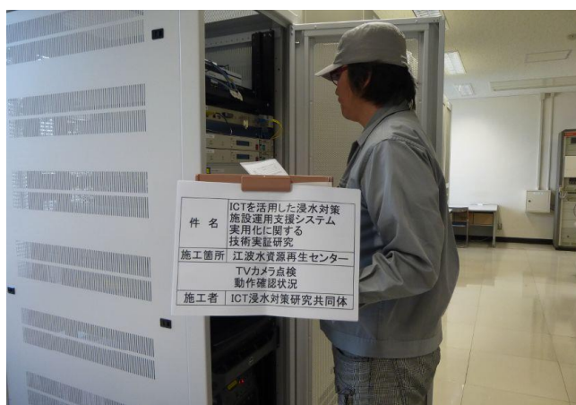
光給電カメラ点検／映像受信状況確認
