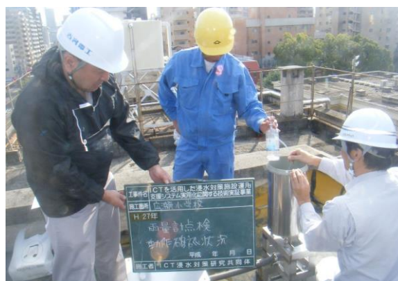
機器動作確認作業／広瀬小学校
