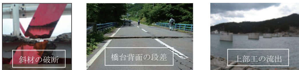
図-1.1.1 突発的に道路橋の供用安全性に重大な支障が生じた事例
