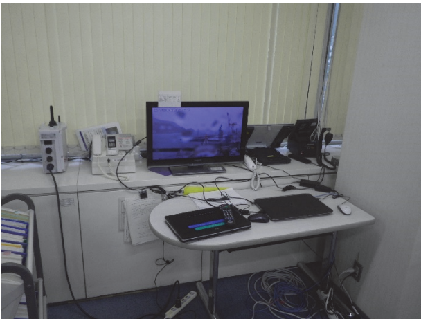
機器設置状況(釜石港湾事務所)
