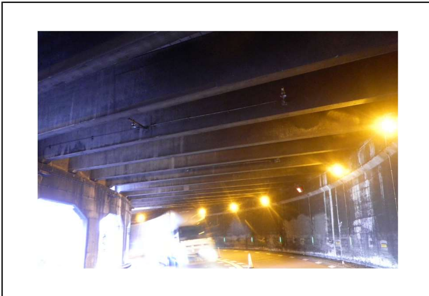
写真番号 S-12.1.1 説明 排煙塵の付着の例。
