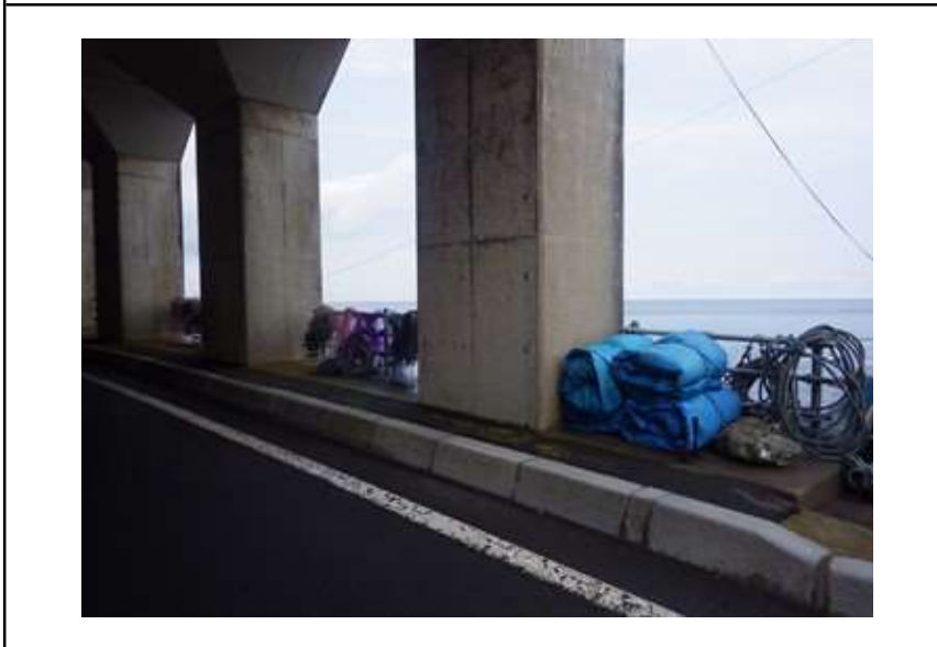
写真番号 S-12.1.2 説明 防護柵や歩道に資材(ロープ・網など)による不法占拠が見られた例。
