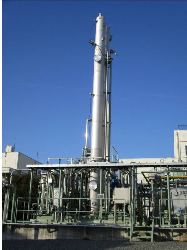
写真2-4 バイオガス精製装置
