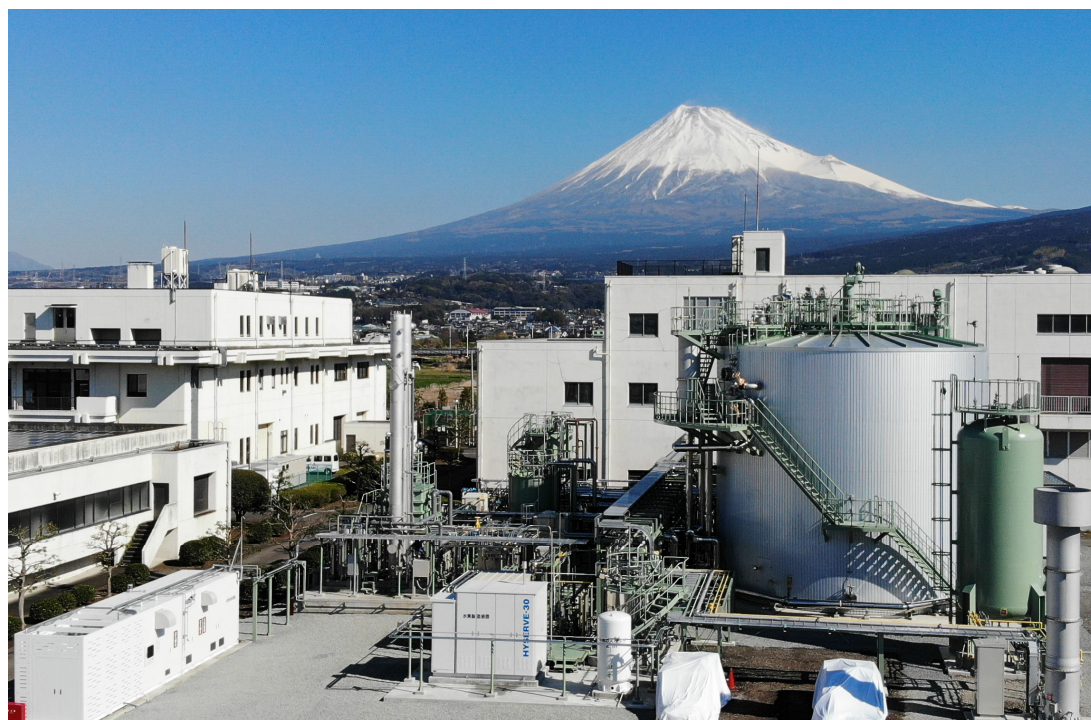
写真2-1 本技術の実証設備全景
