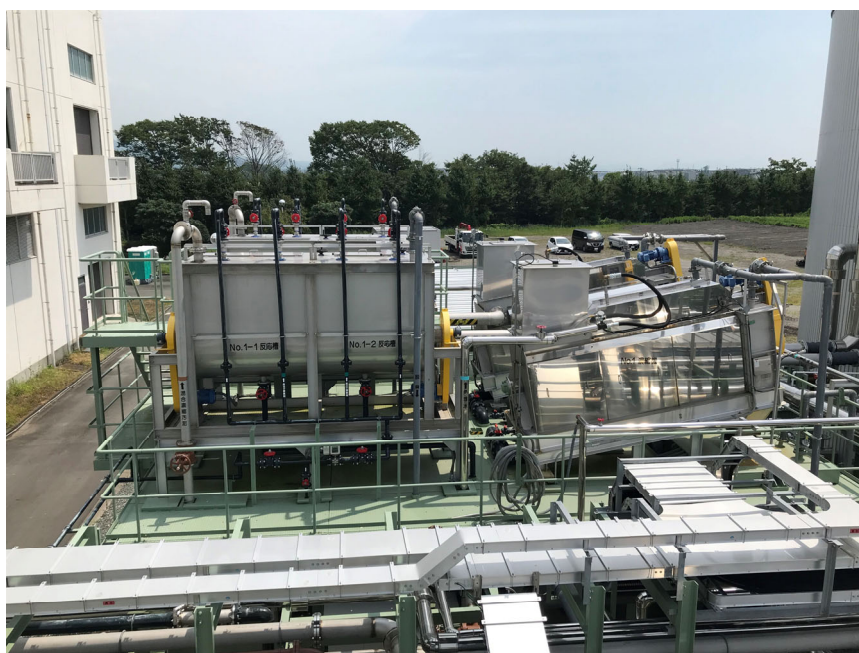
写真 2-2 高濃度濃縮装置
