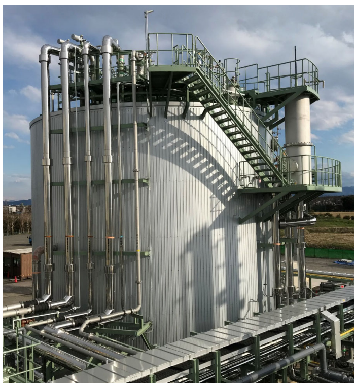
写真 2-3 高濃度消化槽
