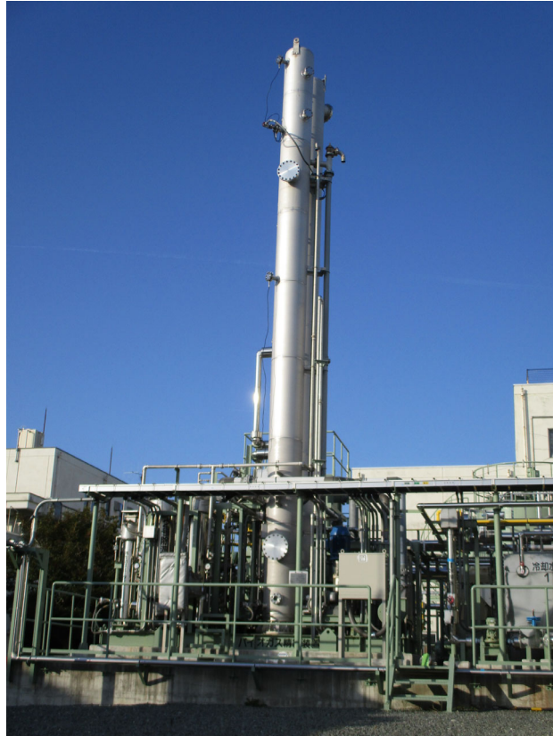
写真2-4 バイオガス精製装置
