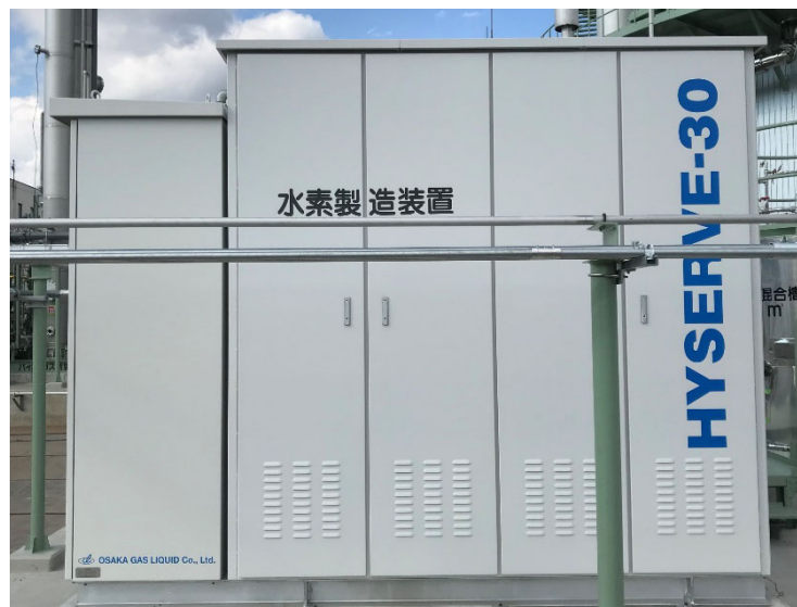
写真 2-6 水素製造装置
