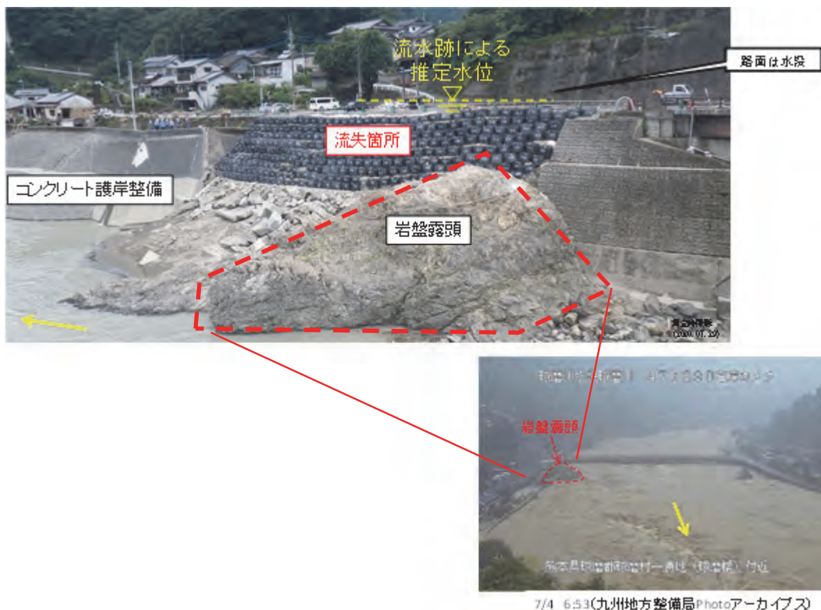
写真-4.1.15 球磨橋下流盛土の国道219号 被災状況 (上写真は、7月29日撮影) (下写真は九州地方整備局HPより)
