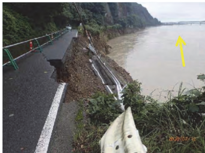
写真-4.1.18 路面の状態 (TEC-FORCE7月12日撮影)
