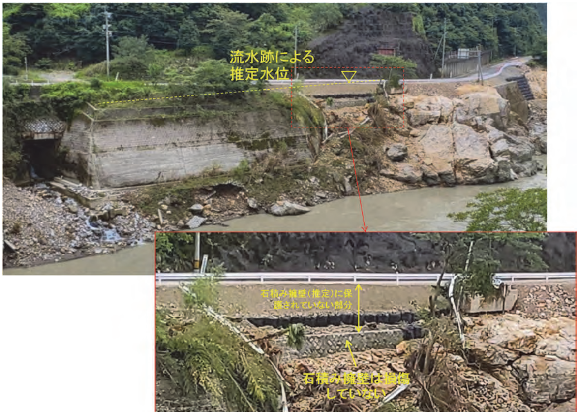
写真-4.1.11 大野大橋に近い箇所の被災状況詳細 (7月29日撮影)
