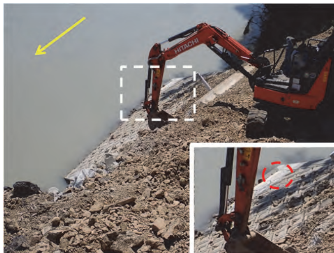
写真-4.1.20 ブロック積擁壁及び路面の状態 (7月30日撮影)
