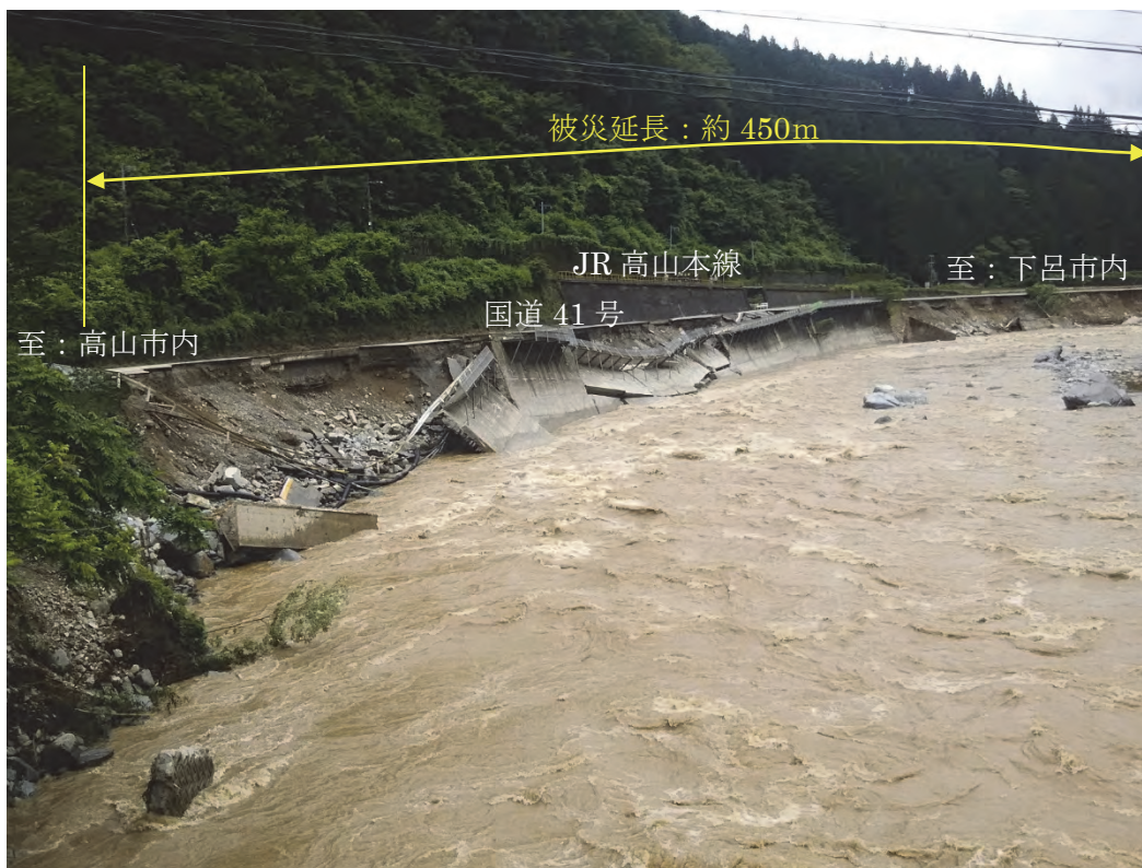
写真-4.1.1 被災状況写真（7月9日撮影、中部地方整備局提供）
