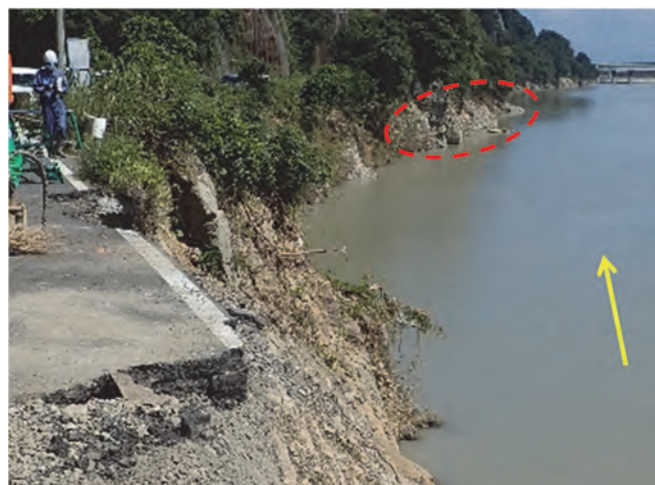
写真-4.1.21 崩壊地点より下流の地山の状態 (7月30日撮影)
