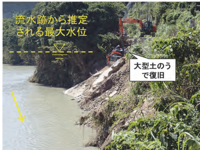
写真-4.1.19 ブロック積擁壁の状態 (7月30日撮影)
