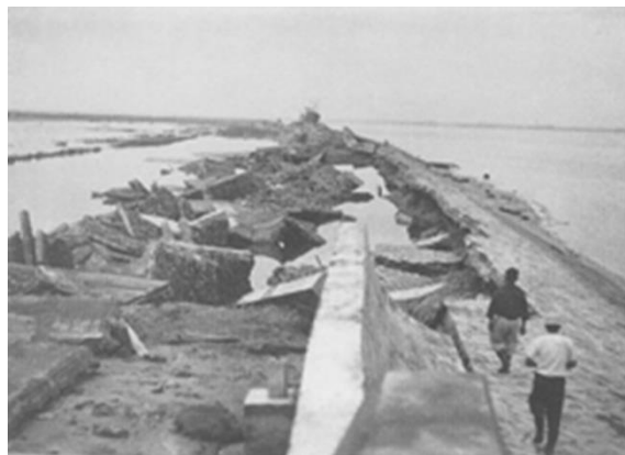
写真2.2 半田武豊海岸での被害 (出典：三河港湾事務所HP)
