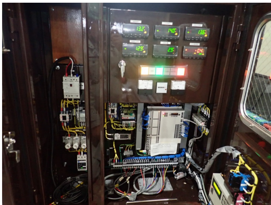
写真 2-6 操作・制御設備の例
