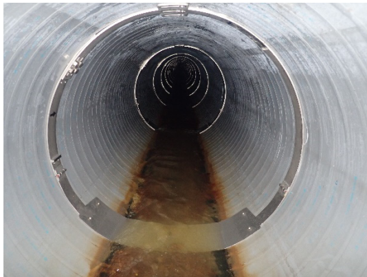
写真 4-1 採熱管固定バンド
