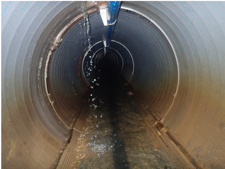
写真 V-4 採熱管写真（管底採熱部）
