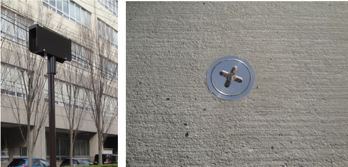
写真 2-5 実証研究施設の制御センサの例（左：降雪センサ本体、右：温度センサ※筐体） ※温度センサは、筐体に内蔵されて舗装面に設置
