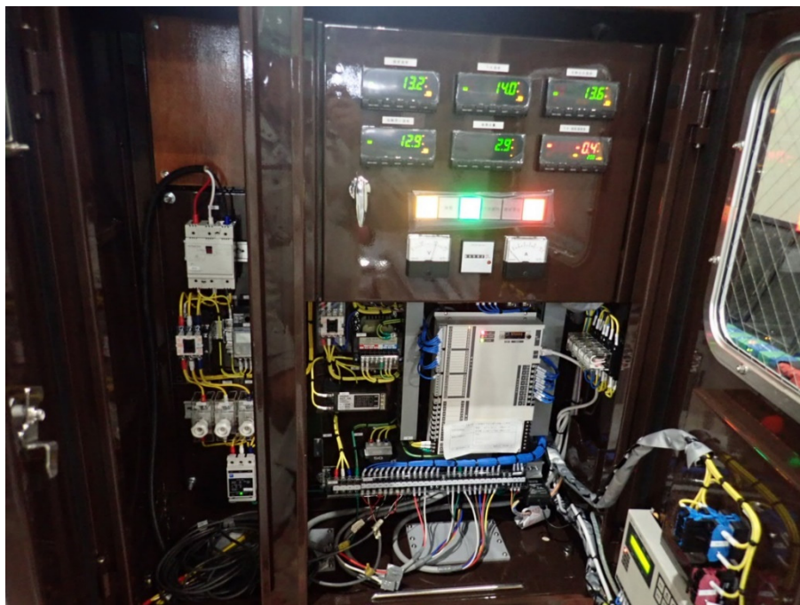
写真 2-6 操作・制御設備の例
