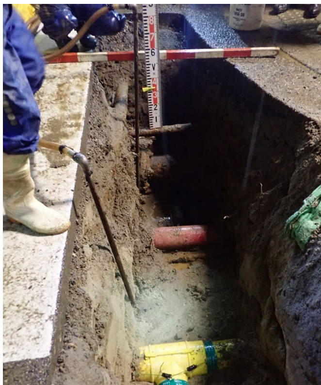
写真 3-2 地下埋設物の試掘調査の一例※詳細設計時や本施工前に行う
