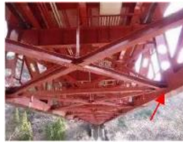
(e) トラス下弦材の確認困難
