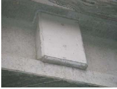
(a) 内部の状態確認が困難
