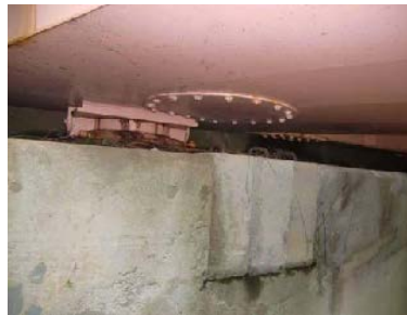
(h) マンホールが開かない
