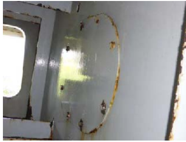
(h) マンホールが重い・小さい
