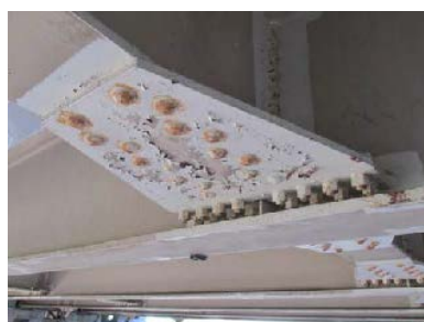
(h) 狭隘部のボルトの目視困難
