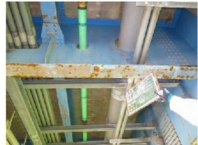
(f) 添架管位置の配慮不足
