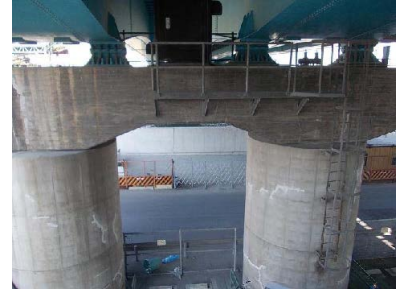
(c) 横断検査路の不足
