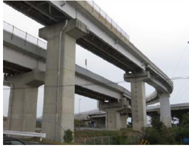
(b) 検査路の未設置
