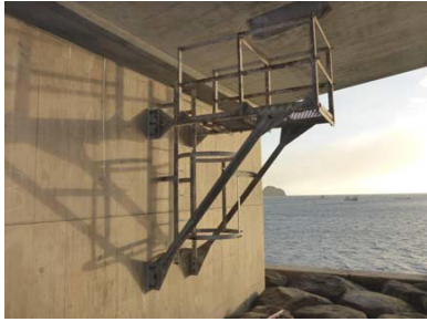
(a) 横断検査路の不足
