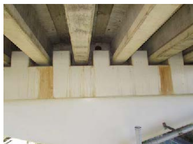
(d) 桁端部の進入困難
