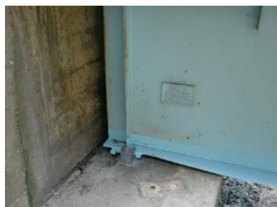
(a) 桁端部と胸壁の離隔が狭い
