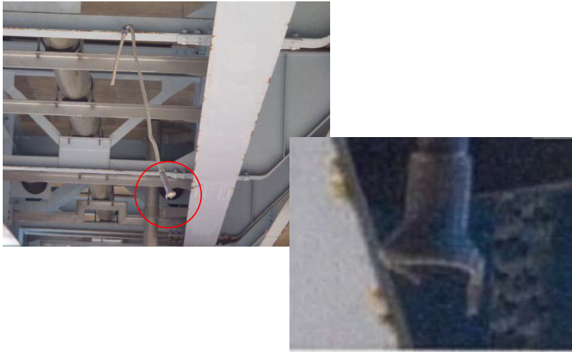
写真-2 排水パイプの脱落例
