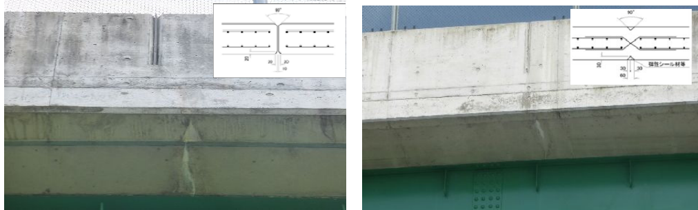
写真-2 膨張目地部に生じたひびわれの例
