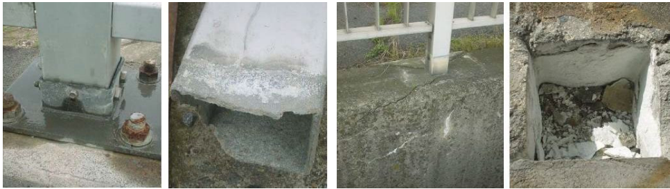
写真-1 支柱基部の損傷例
