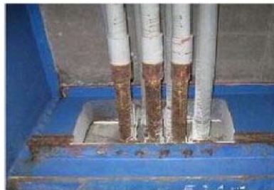
写真-3 添架物の鋼部材の腐食
