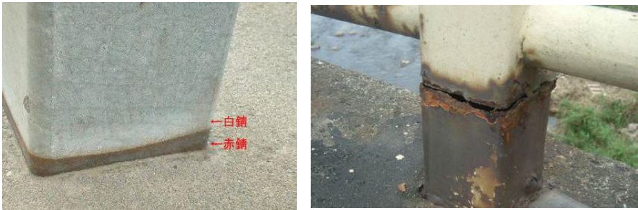
写真-2 防護柵基部腐食の例
