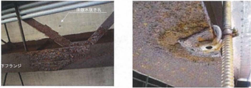
写真-1 床版水抜き孔の影響により層状錆が発生した耐候性鋼材の例
