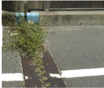
(b) 損傷状況の例
