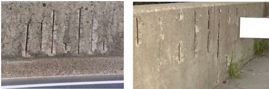
写真-1 壁高欄のはく離コンクリートはく離の例
