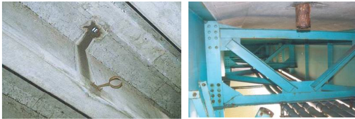
図-1 支持金具の不具合による排水管の脱落
