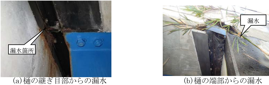
写真-1 伸縮装置の樋からの漏水例
