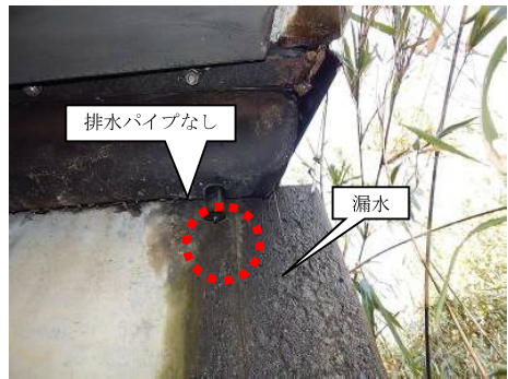
写真-2 排水パイプのない例
