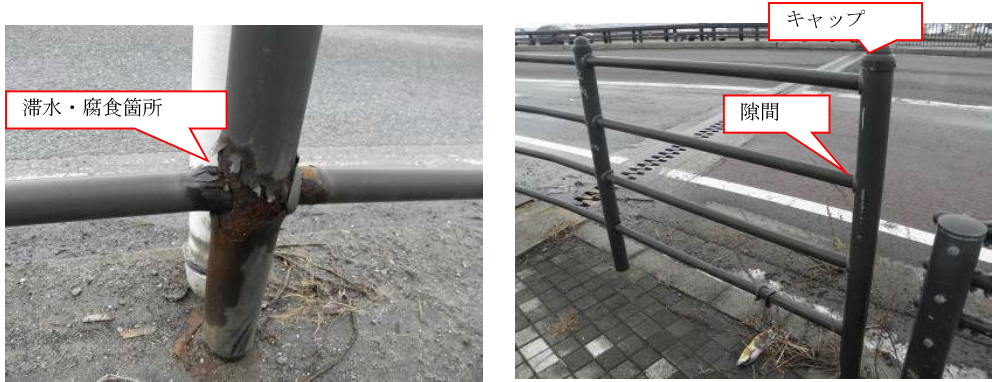
(a) 腐食箇所 (b) 高欄全景
