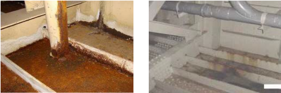
写真-2 箱桁内滞水の例
