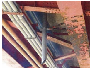
写真-3 下フランジ損傷例
