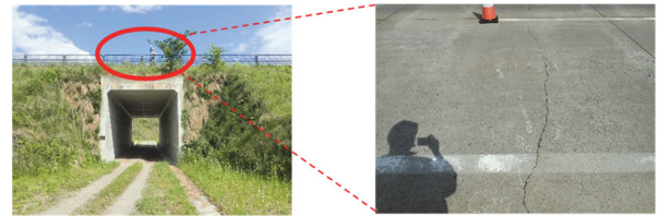
図-5 横断構造物上に発生した横断ひび割れ
