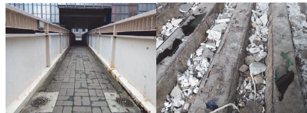
i) 点検時 ii) 撤去時 写真-1 損傷事例
