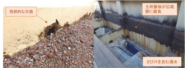
ii) 地覆の腐食の例 (その 2)
