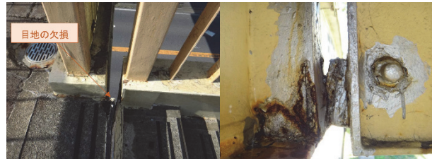
v) フック及びその取り付け部損傷例
