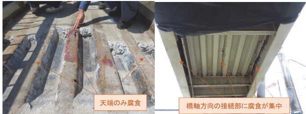
iii) 床版の腐食の例 (その 1)
