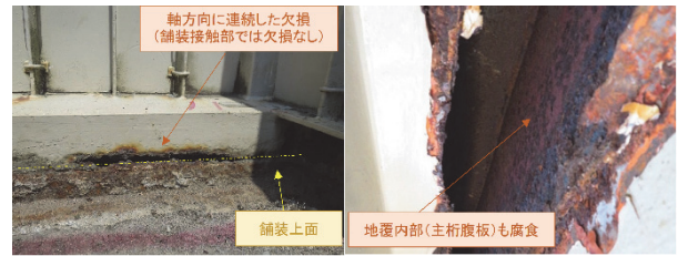
i) 地覆の腐食の例 (その 1)
