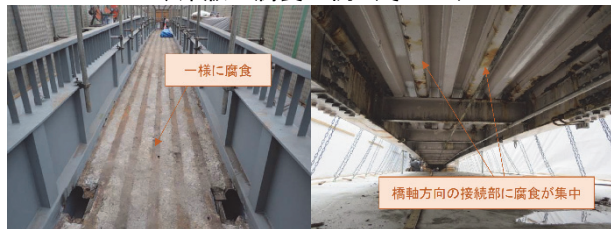
iv) 床版の腐食の例 (その 2)
