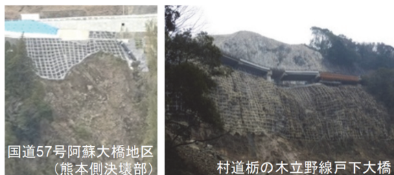
写真-1 急峻な斜面に近接する道路
