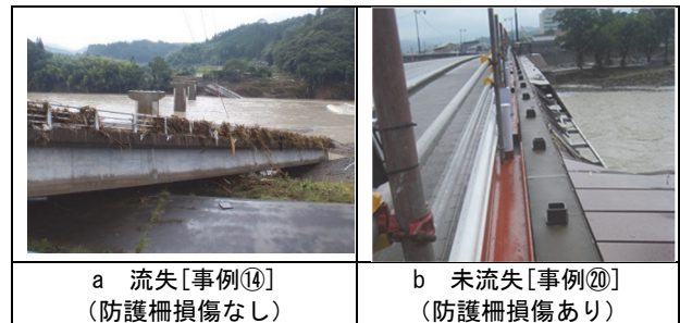
写真-2 R2 球磨川豪雨における被災事例（PC橋）
