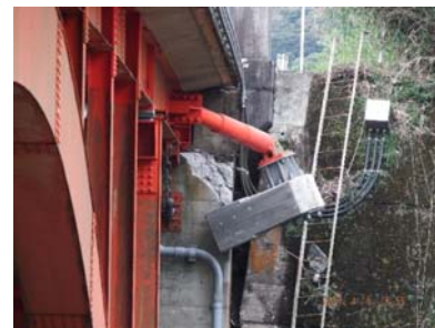
熊本地震の被災事例
