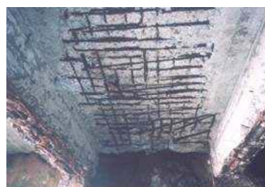
栈橋下面のコンクリート剥離
