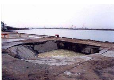
エプロンの陥没
