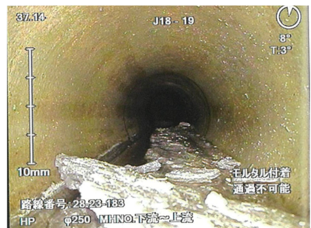
12 モルタル付着 (鉄筋コンクリート管の例)
