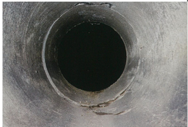
4 管の円周方向クラック (鉄筋コンクリート管の例)
