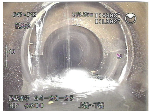
8 侵入水 (鉄筋コンクリート管の例)
