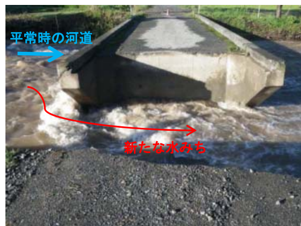
写真 参考-1 橋台背面土砂の完全流失
