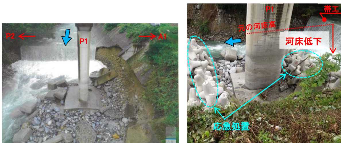
写真 5-12 河床の低下と P1 橋脚基礎の露出
