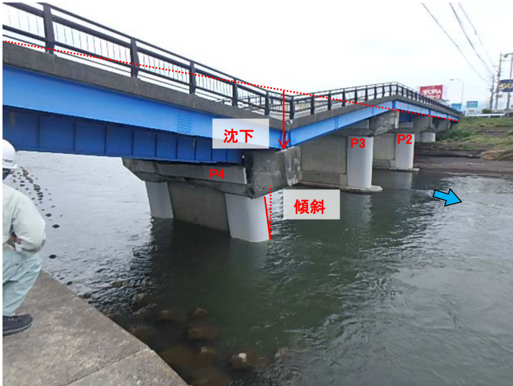
写真 5-6 P4 橋脚の沈下及び傾斜
