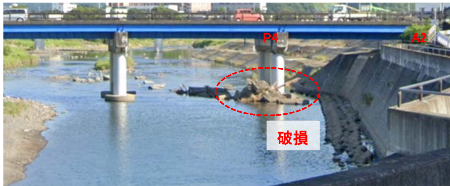
写真 5-11 P4 橋脚周りの洗掘防止工の被災（令和元年 6 月時点） 17)
