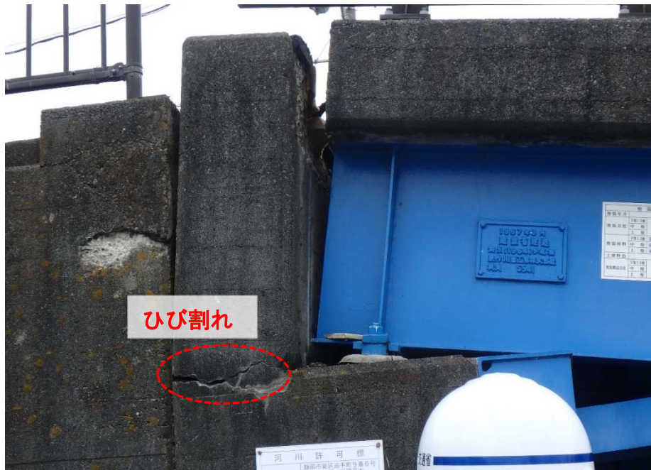
写真 5-8 A2 橋台パラペット基部のひび割れ
