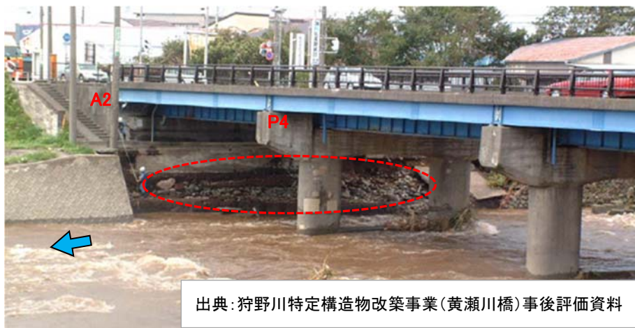
写真 5-10 平成 19 年台風 19 号による A2 橋台護岸の被災
