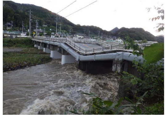
写真 1-1 法雲寺橋の被害
