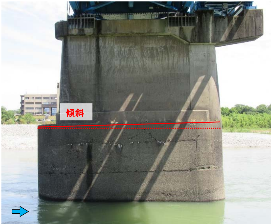
写真 5-1 P4 橋脚の傾斜
