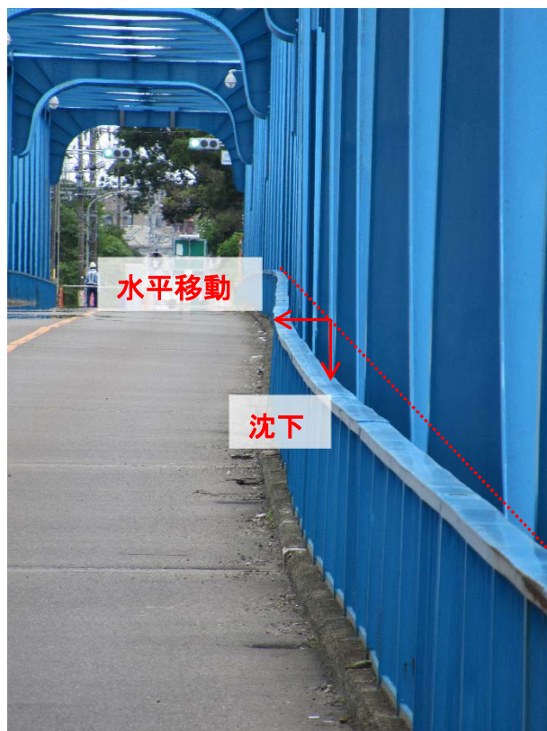
写真 5-2 P4 橋脚位置における上部構造の水平移動及び沈下
