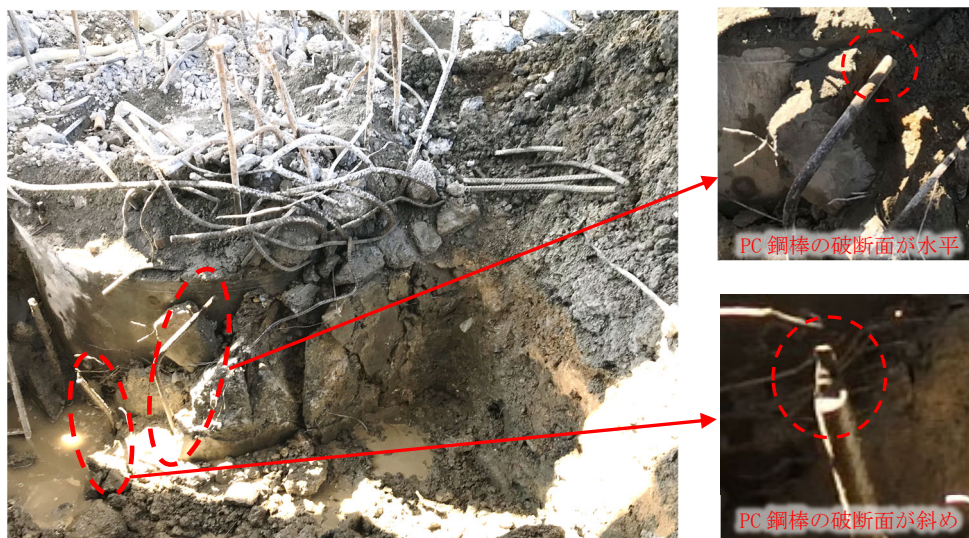
写真 2-⑧ P3 橋脚 PC 鋼棒の破断状況
