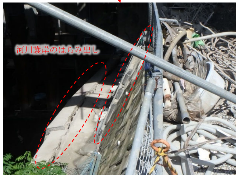
写真 2-⑨ P3 橋脚付近の河川護岸のはらみ出し
