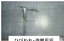
ひびわれ・遊離石灰
