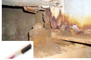
著しい腐食 (錆を除去し減肉量を確認)
