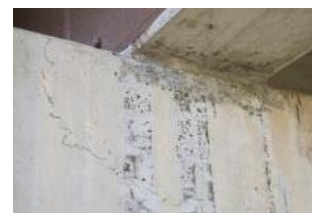
触診によりひびわれに段差を確認できた例。 (損傷原因の推定に活用できる)
