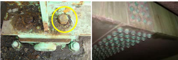
破損ボルトに外見上の変化が見られない例 (打音検査や触診により確認する)
