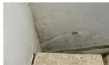
保護塗装にみられるひびわれ。 (打音検査によりコンクリートの状態も確認する)
