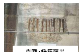
剥離・鉄筋露出
