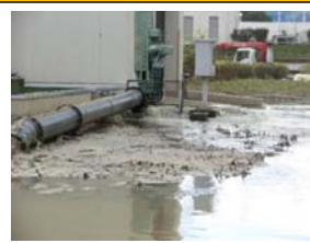
C県内下水処理場流入渠からの下水溢水
