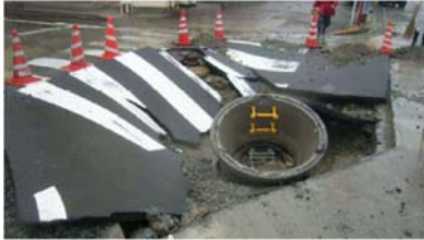
人孔周辺の舗装破損
