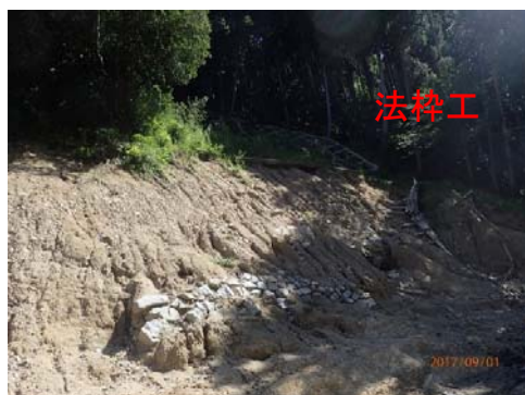
施設下部浸水による崩壊
