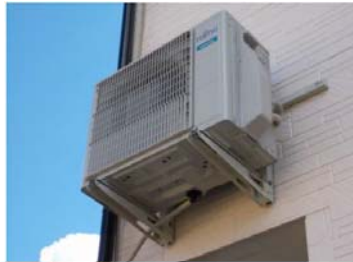
空調室外機が水没し、復旧に時間を要したため、取り付け金具を用いて外壁の上方(1階軒高)に設置。
