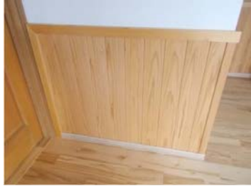
FL+1mの浸水であったが、内壁全高を張替える被害となったため、部分的な補修で対応できるように見切り材を入れて内壁(壁内の断熱材を含む)を腰高で区分。
