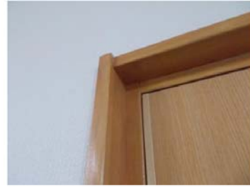
浸水で既製品扉の建具枠(合板)が変形し、全面交換となったため、再利用が可能な無垢材による造作で建具枠を構成。
