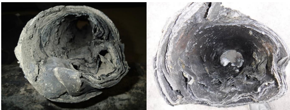
写真 2.1-1 硬質瀝青管の劣化状況
