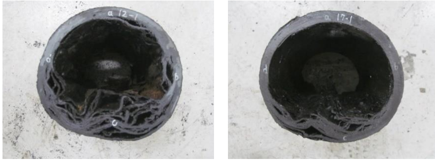
写真 3. 4-2 JSWAS K-1 の規格値を下回った硬質瀝青管の劣化状況（左：No. 27、右：No. 34）
