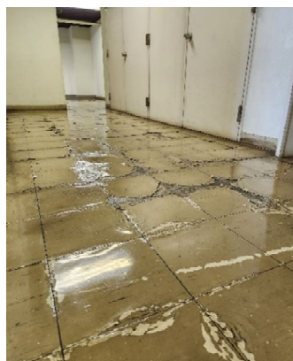
床タイルの劣化 (水質水文共同実験棟)
