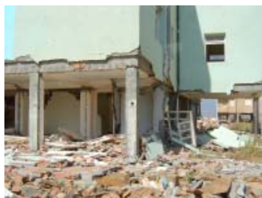
写真 2 1 階の煉瓦壁の崩落
