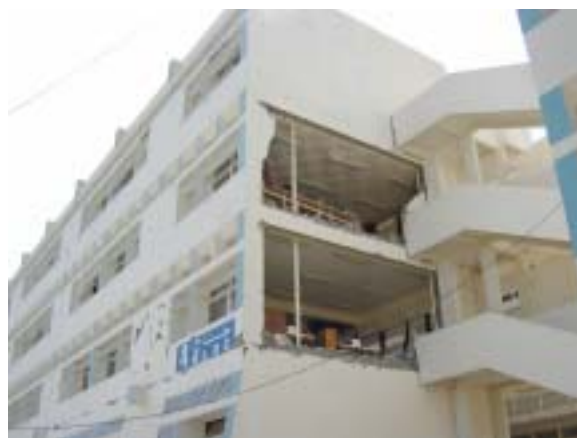
写真 2 4 壊れ落ちた煉瓦の外壁
