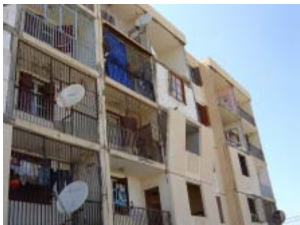
写真 2 1 外装 PC パネルの損傷・落下
