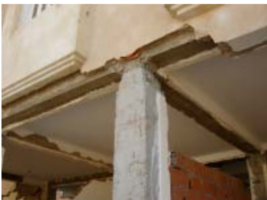
写真 1 7 柱の打ち継ぎ部の被害
