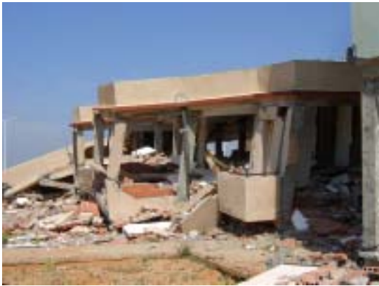
写真7 大破した建物
