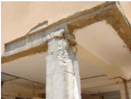
写真 1 8 柱の打ち継ぎ部の被害
