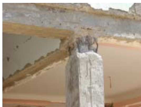
写真 6 柱端部の破壊
