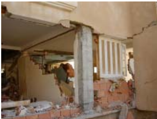
写真 1 6 大破建物の内部
