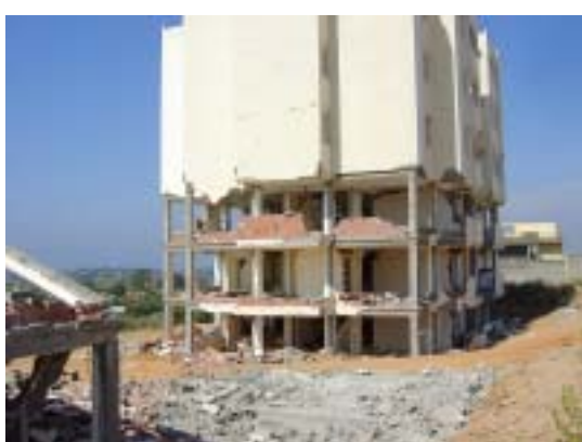
写真 5 崩壊を免れた建物
