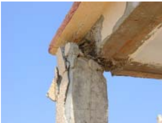
写真9 接合部の破壊
