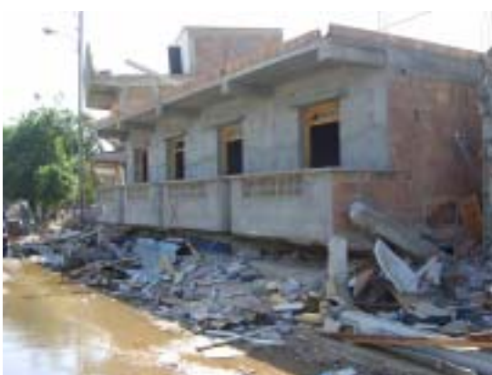
写真11 ピロティ階の崩壊
