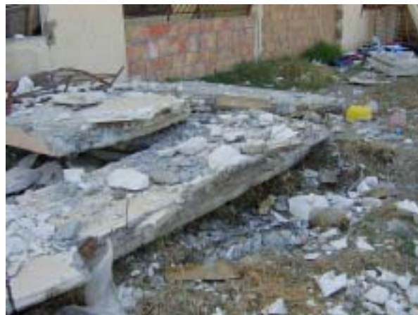
写真 2 2 落下した PC パネル
