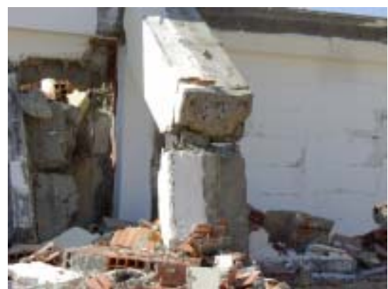
写真10 柱の破壊（主筋の破断）
