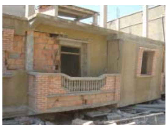
写真12 ピロティ階の崩壊
