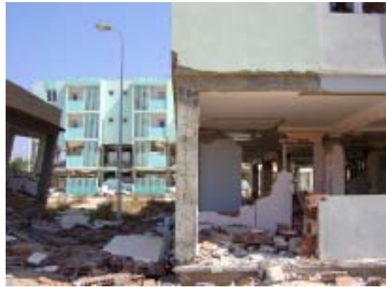
写真8 柱端部の破壊
