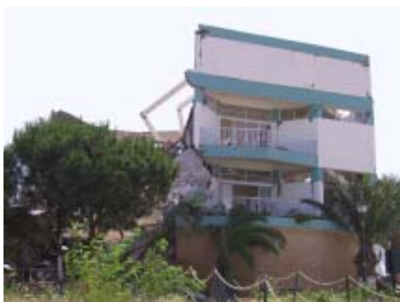
写真 2 3 崩壊した大学の講義棟
