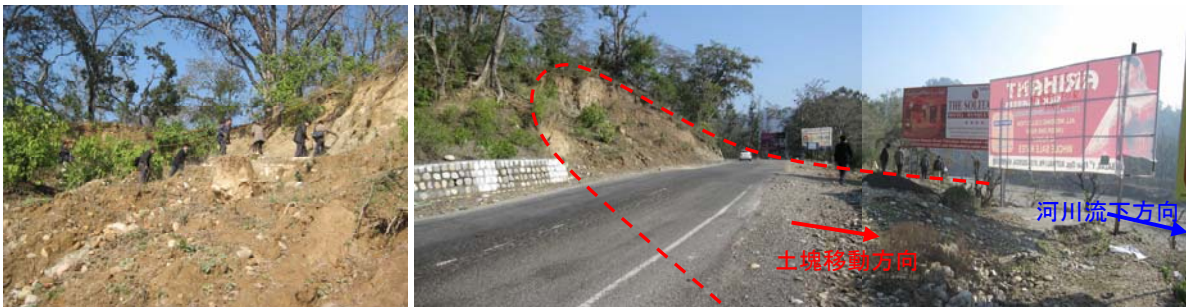
写真 左：地すべり滑落崖の調査 右：地すべり被災箇所を道路より望む（右側は河川）
