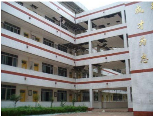
写真9 学校建築の天井脱落等 (綿竹市市街地)
