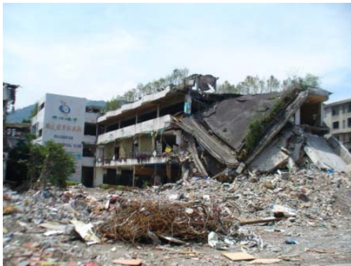
写真5 都市部の中層建築物の層崩壊 (都江堰市街地)
