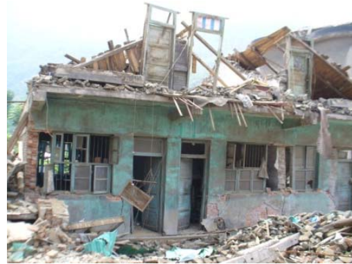
写真4 農村住宅の層崩壊 (安県擂鼓鎮)
