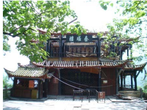
写真6 歴史的建築物の屋根瓦の脱落等 (都江堰市)
