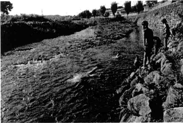
写真-4 平井川: 外湾部の護岸を急傾斜とし、根固工を深い位置に設置している (出典: ポイントブック)
