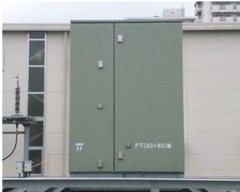
（電力地上機器（表面））
