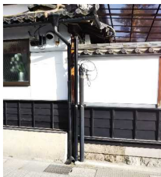
(1管で立ち上げられた通信線)
