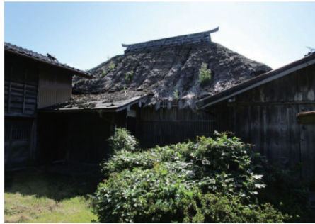
荒廃した武家住宅
