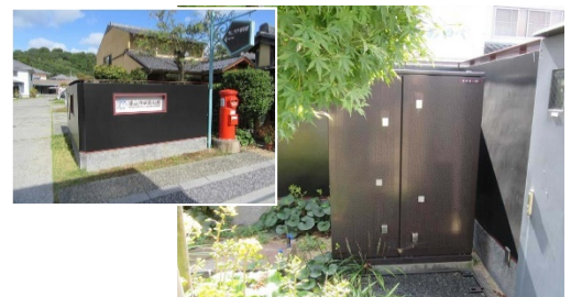
津山洋学資料館への地上機器の設置状況
