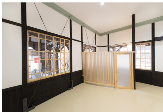
後補と分かるブレースによる構造補強
