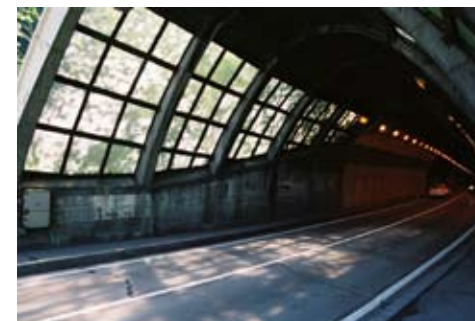
入口から内部へ徐々に採光面積が少なくなる坑口により運転者の明暗順応を図っている。
