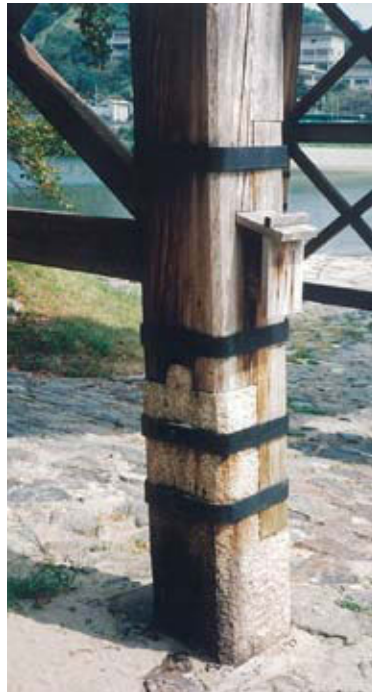
木橋に水は大敵である。地面との接点は石、部材端部は鼻板で覆われている
