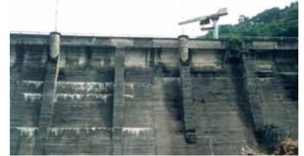
袖堤部の扶壁 (出典24-9)
