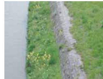
■天端を巻天端として天端コンクリートが見えないようにしている。さらに、その上に植物が繁茂し景観的に馴染んでいる。(出典27-4)
