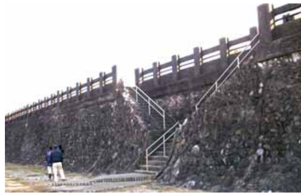
長良川(岐阜市)の置堤(出典28-1) 長良川(岐阜市)の置堤は、金華山の麓という場所柄を反映した玉石積みの護岸の上部に組み込まれている。揖保川の置堤を設計した当時の技術者は、長良川の置堤の視察を行い、参考にしたといわれている
