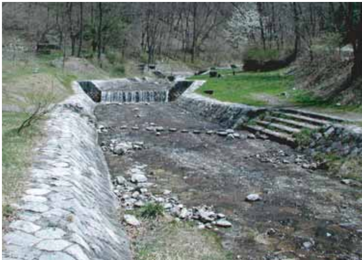
■昭和61年より始まった砂防環境整備事業では、フランス階段工上流部の砂防施設も巻天端で整備するなど、下流のフランス階段工を意識したデザインとなっている。(出典19-16)
