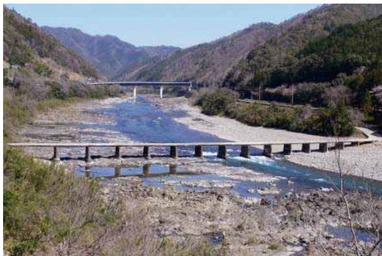
四万十川の半家沈下橋（潜橋）（出典28-15） 後ろに架かる通常の橋梁と比べるとその特徴の差が明瞭である
