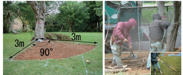
写真 2 根系調査範囲（左）とエアースコップを使用した掘削状況（右）
