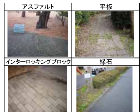
写真 1 構造物被害の状況
