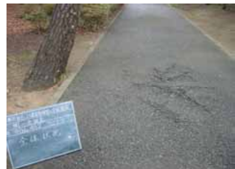
写真 2 クロマツによる被害
