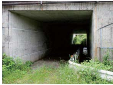
BC: 盛土部においてコンクリート製ボックスを設置し道路下を移動させるアンダーパス(東富士五湖道路)
