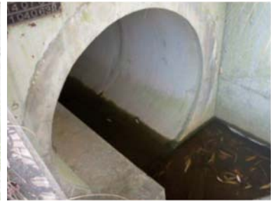
PC: 盛土部において排水兼用のコンクリート製パイプを設置し道路下を移動させるアンダーパス(豊富 BP)
