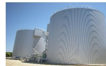
汚泥消化施設の導入によるバイオガス発電 (○○○○t-CO 2 削減)
